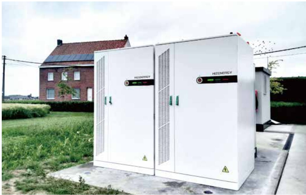
Belgien: 125 kW / 279 kWh
